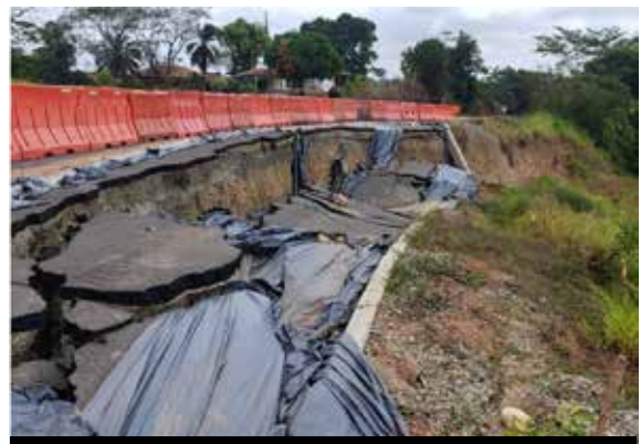
Fotografía 1. Pérdida de la banca en el 34+600, costado derecho, vía Remedios - Zaragoza.
