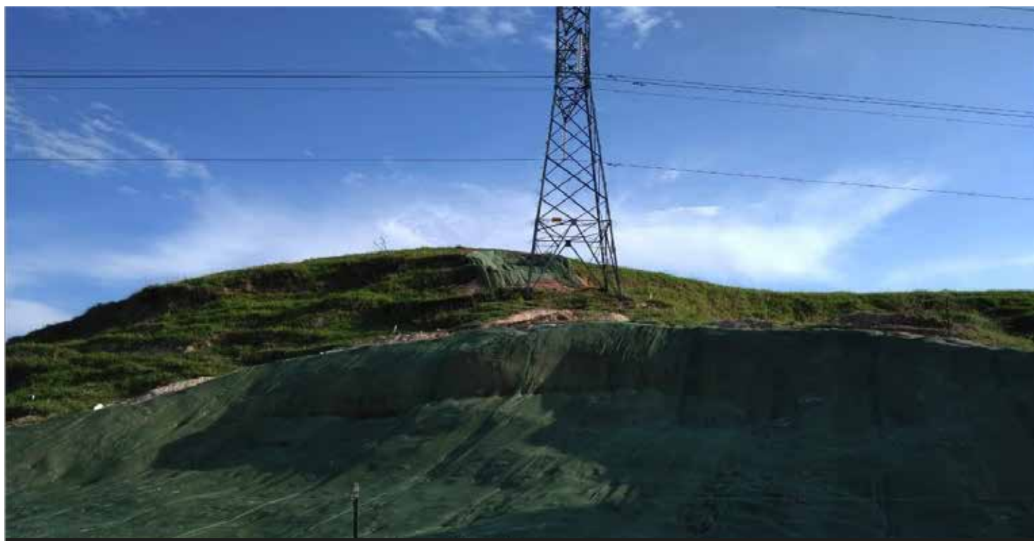
Fotografía 6. Estructura de protección en funcionamiento.
