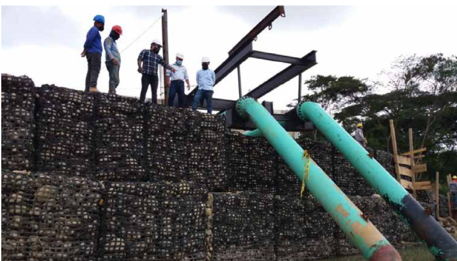
Fotografía 9. Estructura de protección en funcionamiento.
