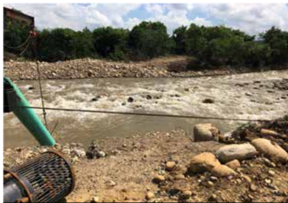
Fotografía 1. Modificación en la dinámica del río, sentido de flujo en dirección al talud sobre el que reposa el cuarto de bombas y la bocatoma.
